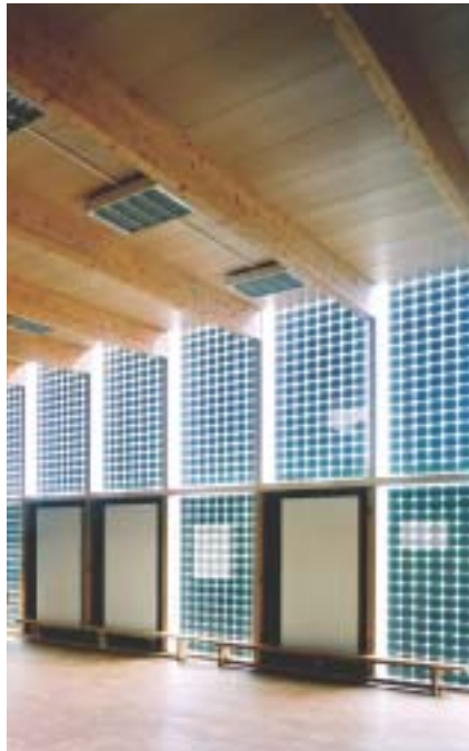
Des vitrages avec incorporation de cellules photovoltaïques. École à Morschwiller (68), TOA architectes.
