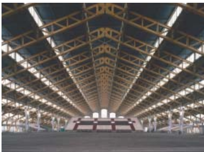
Grande charpente métallique à rotules. Halle Tony Garnier (1928) à Lyon (69). Rénovation par Reichen et Robert (1989).
